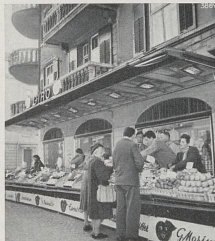
L'étalage extérieur d'un grand magasin de primeurs, à Zurich, chauffé au moyen de 9 panneaux rayonnants Schwank, fonctionnant au gaz.
