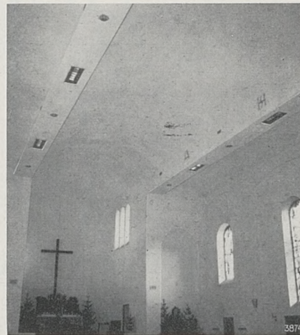
Intérieur de l'église paroissiale Saints-Pierre et Paul, à Lustenau (Vorarlberg). Les panneaux rayonnants sont encastrés dans le plafond de l'édifice
